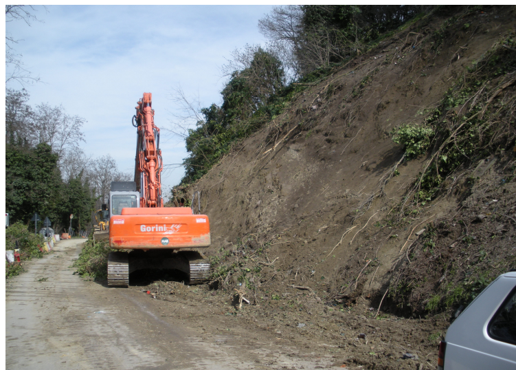
Figura 11 Dissesto sulla via Roversano, Comune di Cesena
