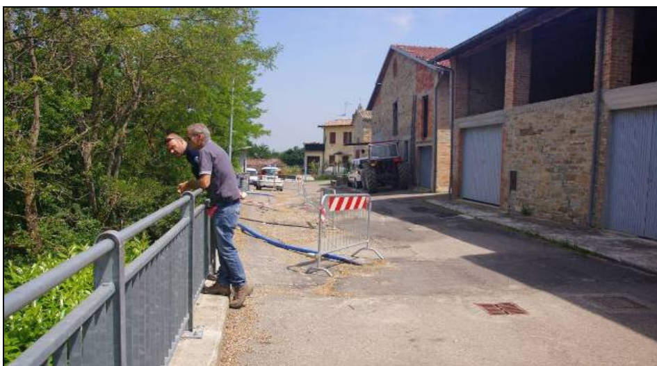
Fig. 9: situazione della frana di Pietta nella primavera 2013. Coinvolta la strada interna al paese, in seguito al cedimento parziale del cordolo su pali a sostegno della strada.
