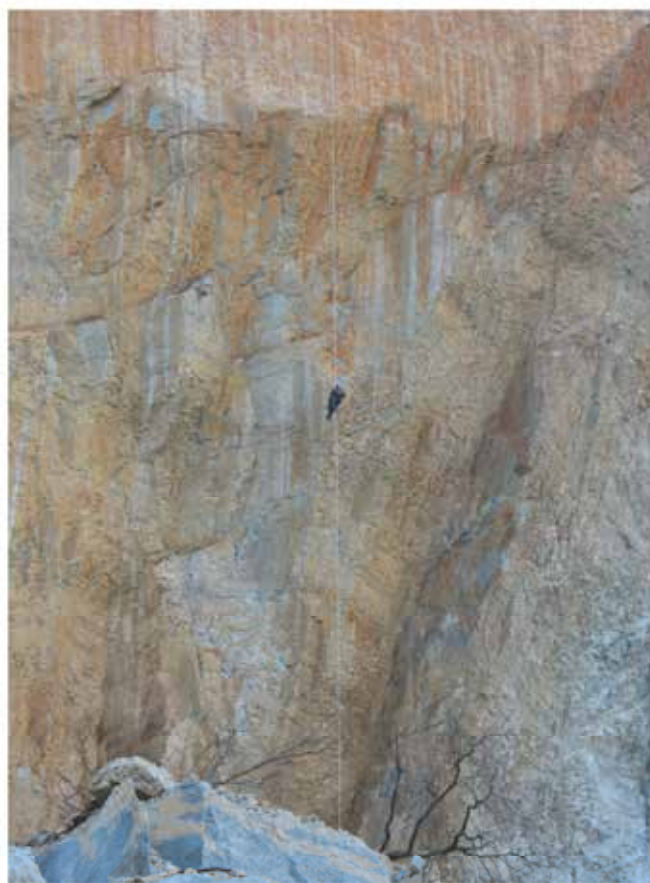
Fig. 16 - Calata del geologo rocciatore lungo la parete del crollo. Si noti la colorazione rossastra della superficie per via dell'ossidazione a seguito delle infiltrazioni d'acqua prima del crollo.
