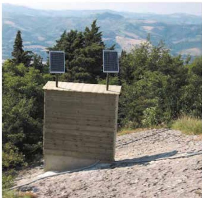
Fig. 26 - Centraline di acquisizione dati con relativi pannelli solari per l'alimentazione. Le centraline (non visibili) sono state opportunamente dotate di struttura protettiva.
