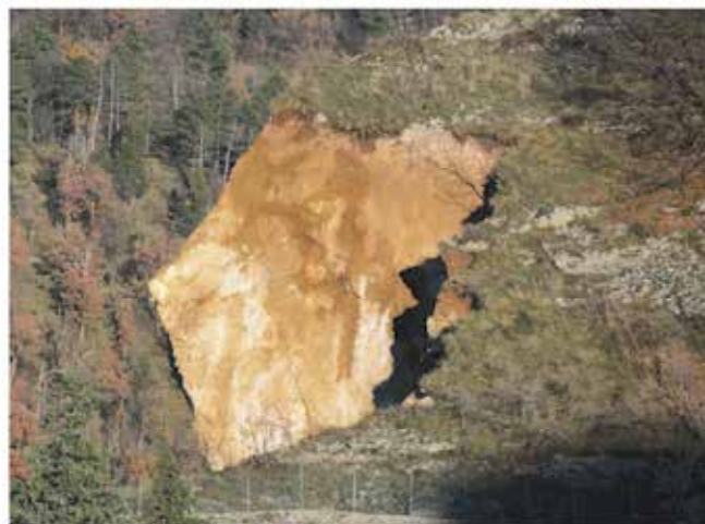
Fig. 8 - Il confronto delle due foto, prese all'incirca dallo stesso punto di osservazione, evidenzia il volume di roccia crollato nell'evento "dicembre 2014".
