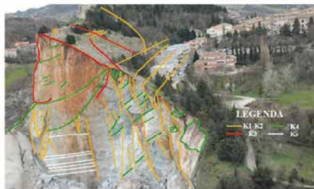
Fig. 17 - Principali fratture rilevate lungo la parete del crollo (parete nord).
