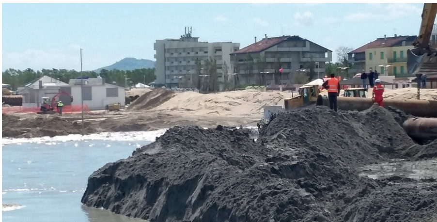
Figura 28. Spiaggia di Misano adriatico, fasi delle lavorazioni a terra per il refluito del materiale proveniente dai depositi ad oltre 55 km al largo
