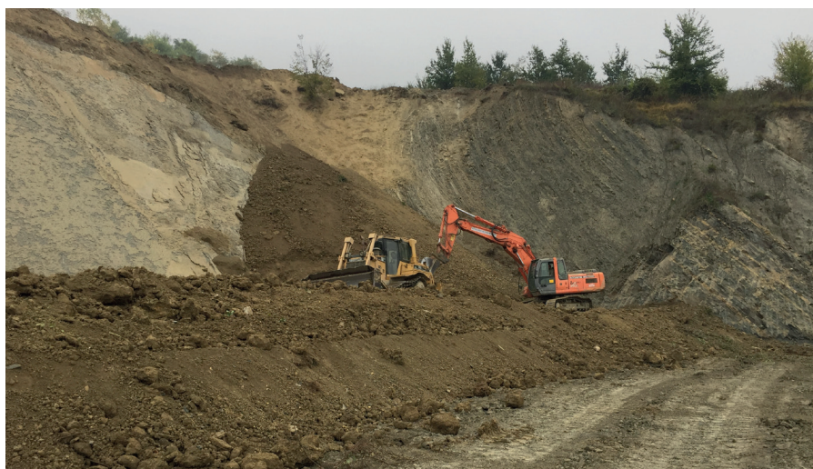
Figura 4. Frana di Montevecchio
