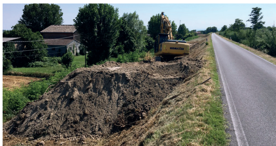
Figura 6. Frana argine destro fiume Montone, in località San Marco, nel comune di Ravenna
