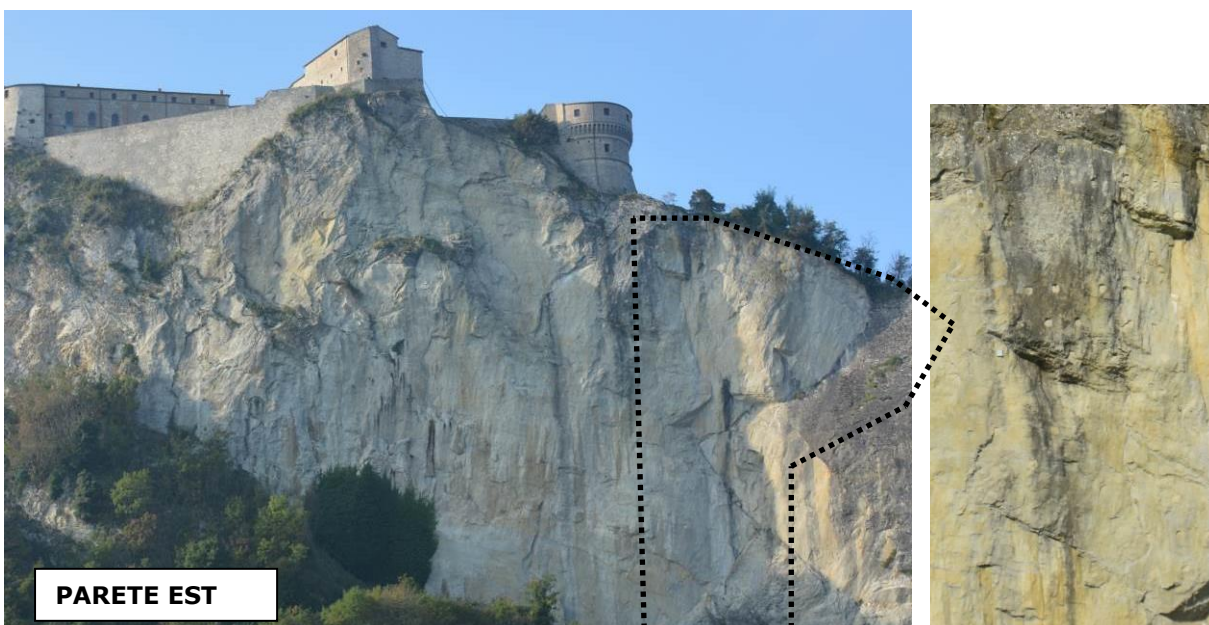
Figura 15 - Settore consolidato durante gli interventi eseguiti negli anni '70. A fianco si apprezza un dettaglio della parete in cui si osservano i segni evidenti delle perforazioni.
