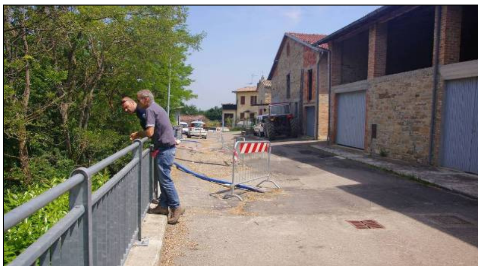
Fig. 9: situazione della frana di Pietta nella primavera 2013. Coinvolta la strada interna al paese, in seguito al cedimento parziale del cordolo su pali a sostegno della strada.
