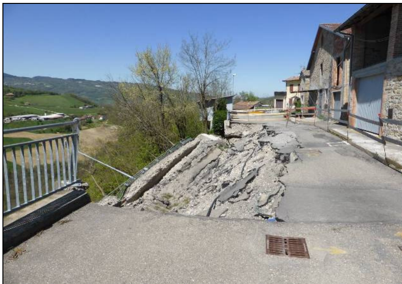
Fig. 8: situazione in seguito all'evento 2014. Compromessi la strada interna al paese e gli edifici prospicienti.
